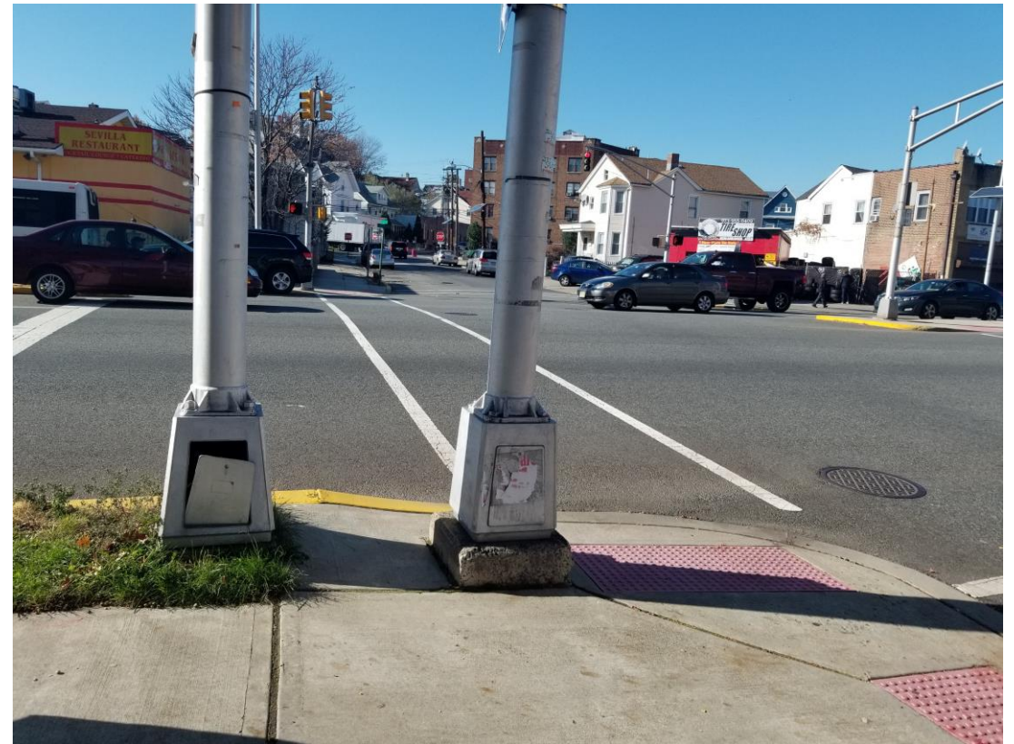
Varias obstrucciones prohíben Seguro acceso peatonal al paso de peatones
