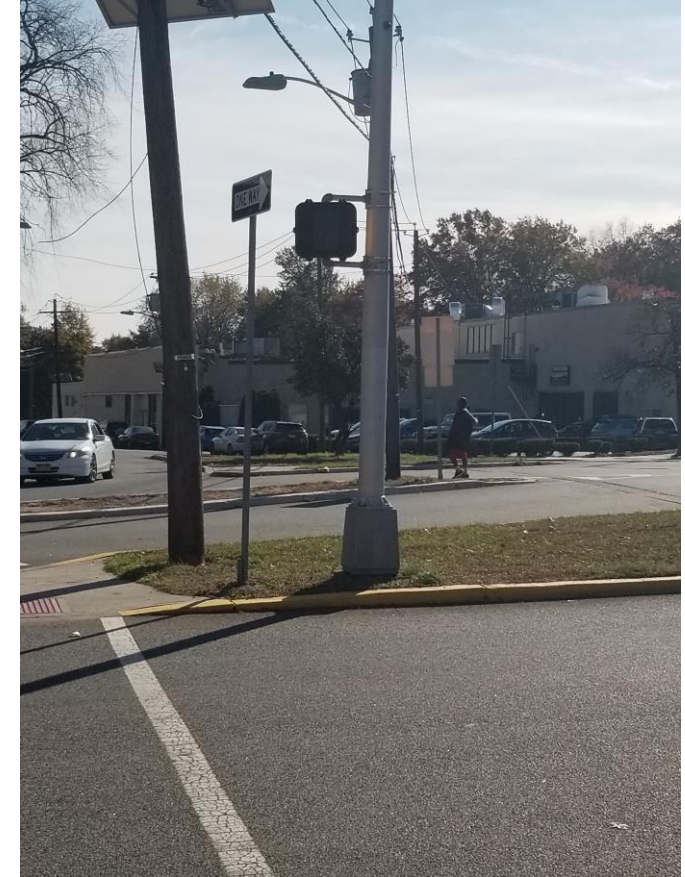
Unos semáforos no funcionan
